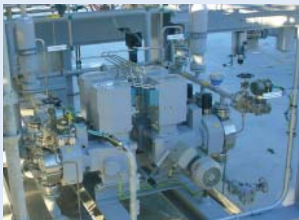
Glycol motor: sterk instrumentatie fitwerk.
